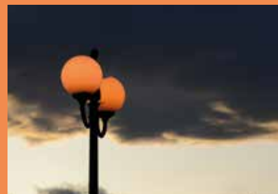
L'éclairage public est domaine sur lequel le SDEEG accompagne la Ville
